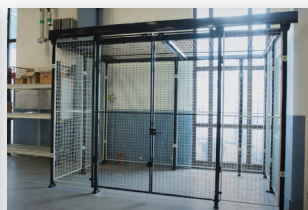
Bod- og lagersikring
