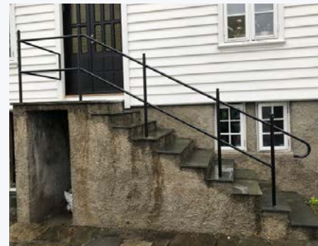
Rekkverk som passer inn i miljøet.
